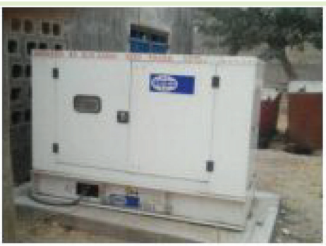
Fig. 5.1 A power generating plant, Fagge L.G.A).
